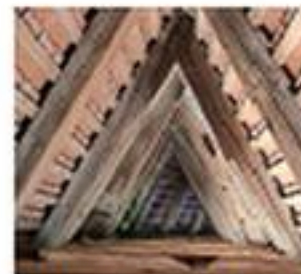
Spitzböden brauchen Belüftung, damit die Feuchtigkeit entweichen kann. Anders als hier sind sie aber oft hermetisch abgedichtet.
