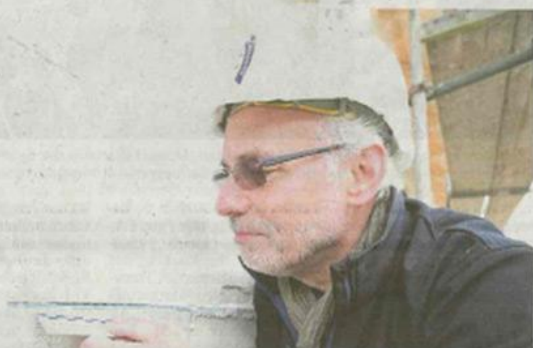
Alles akkurat? Udo Schumacher-Ritz prüft, ob die Betonziegel korrekt verbaut worden sind.
